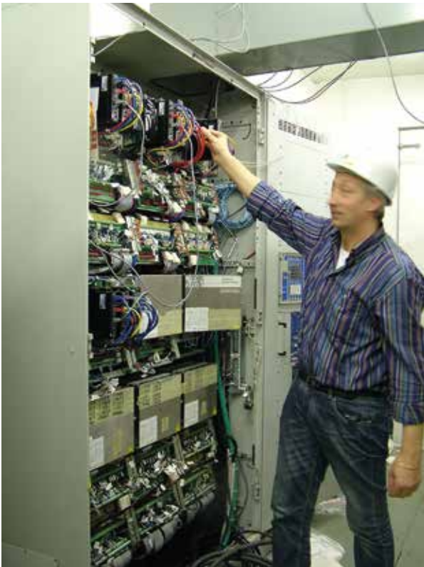
Verifiche funzionali al sistema di controllo del Turbogas
