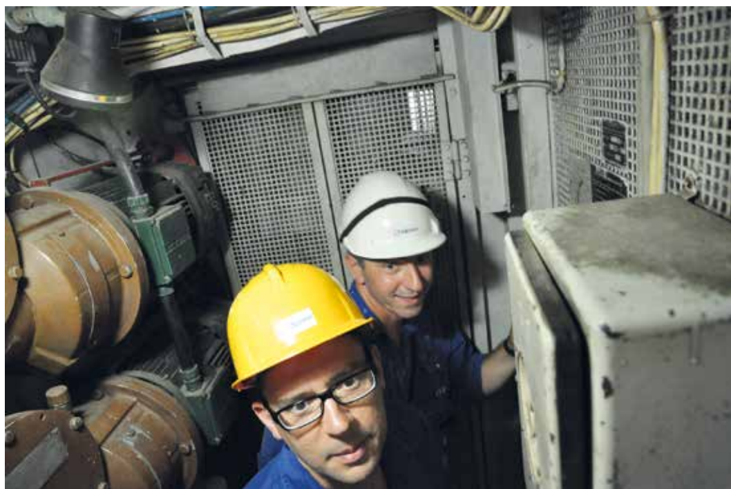
All'interno dell'ascensore, sono visibili sulla sinistra i due motori per la movimentazione della cabina
