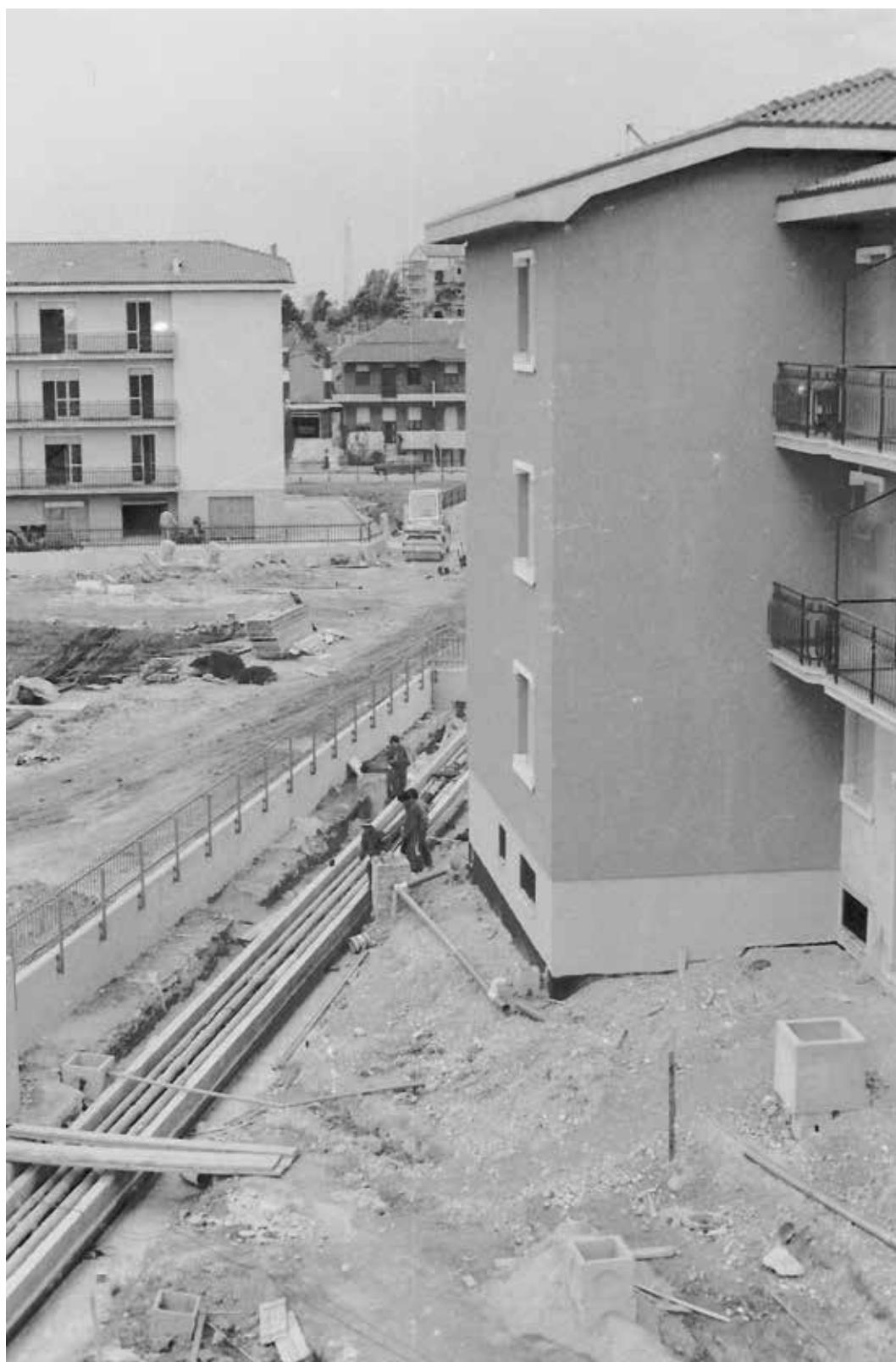
Maggio 1981 Cunicolo per il passaggio delle tubazioni del riscaldamento centralizzato
